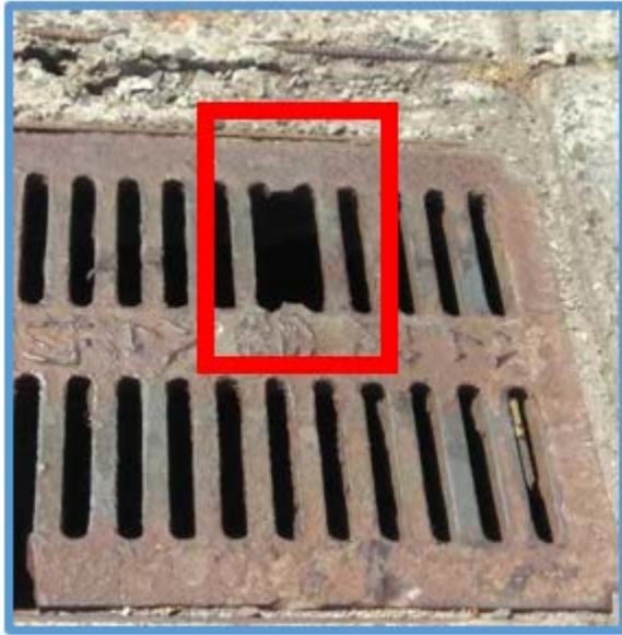
溝蓋損壞情況-水柳腳路 (已先置放鐵板)
