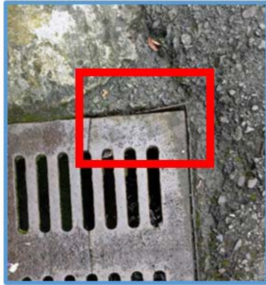
蓋框變形情況-水柳腳路
